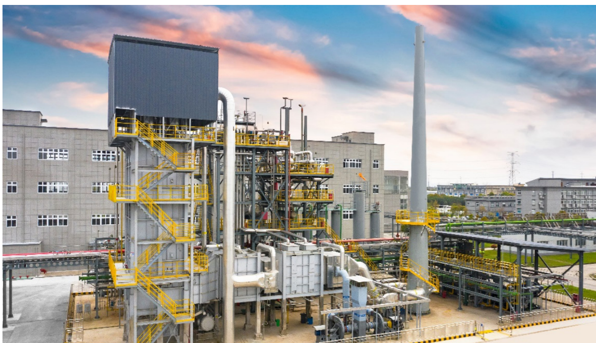
图 2-17 天然气制氢装置
