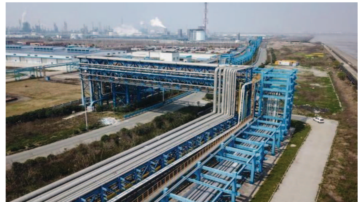
图 2-13 宁波石化经济技术开发区高标准化工管廊现场图
