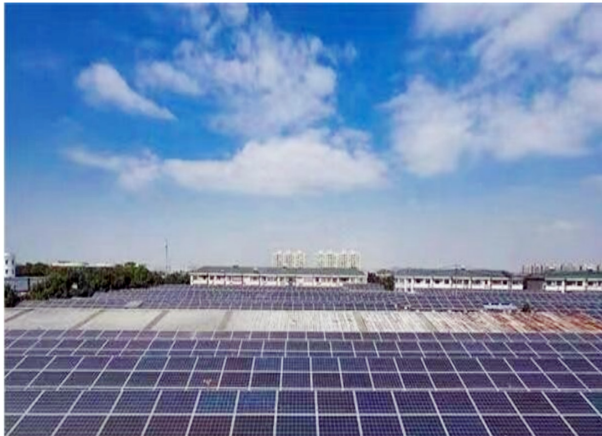
图 2-14 屋顶集中连片光伏设施现场图
